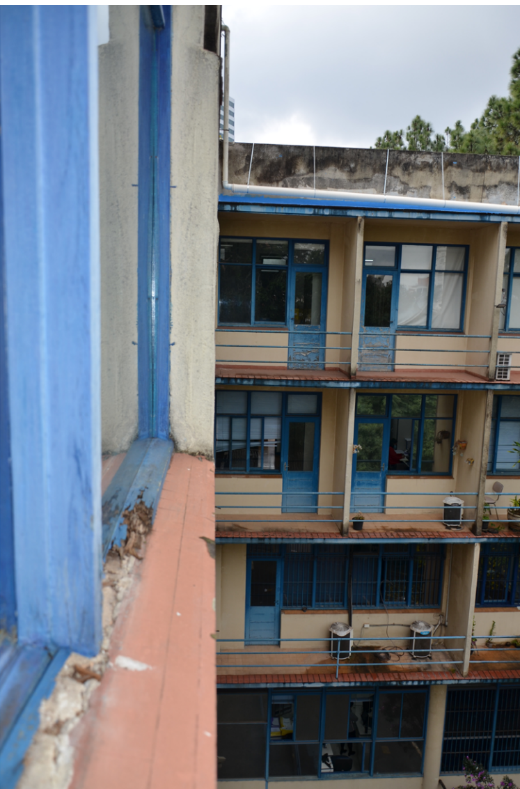
Fachada da EEUSP - necessidade de restauração
